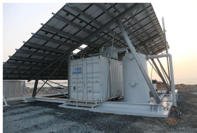
Ci-dessus : installation de dessalement solaire OSMOSUN® déployée à Abu Dhabi. Crédits photos : Mascara NT
